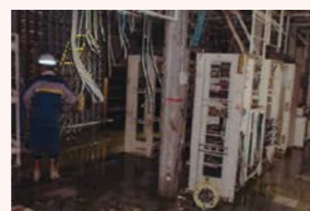
ラック上部まで浸水(真備ビル)
